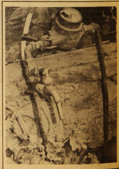
Medidor "brujo", marca de 10 en 10 los metros cúbicos...
