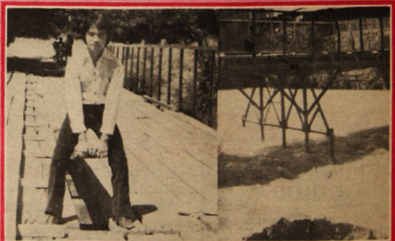
MAL ESTADO. — Max, el papá de "Don Hipo", nos muestra como están de sueltos los tabloncitos del puente peatonal de Río Blanco. Sería bueno que alguien se preocupara del asunto. ¿No les parece?
