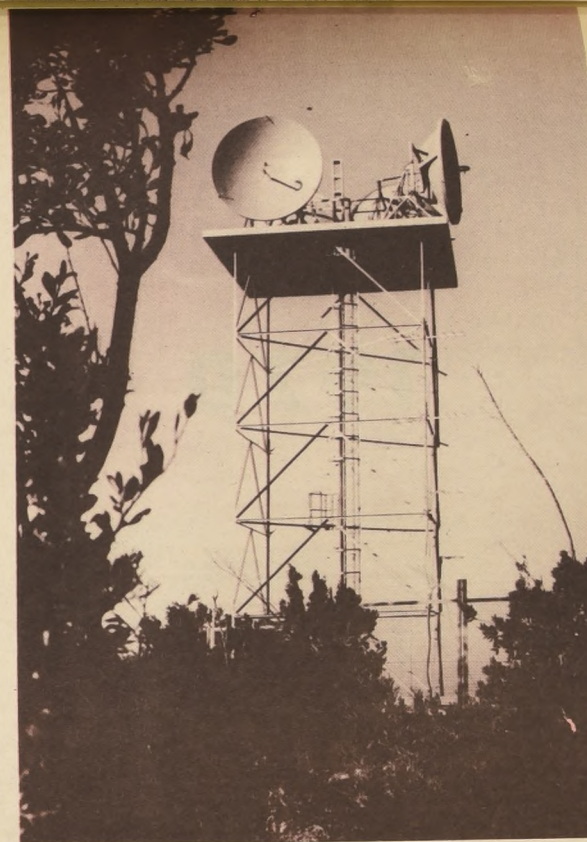
Antenas de Microondas de la Red Troncal Nacional (sector sur).
