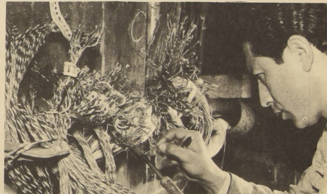
Por este maremagnum de cables derecha, se cursara parte de las 1.800.000 llamadas que diariamente realizan los santiaguinos exclusivamente, dentro y fuera de la ciudad, dentro y fuera del país.
