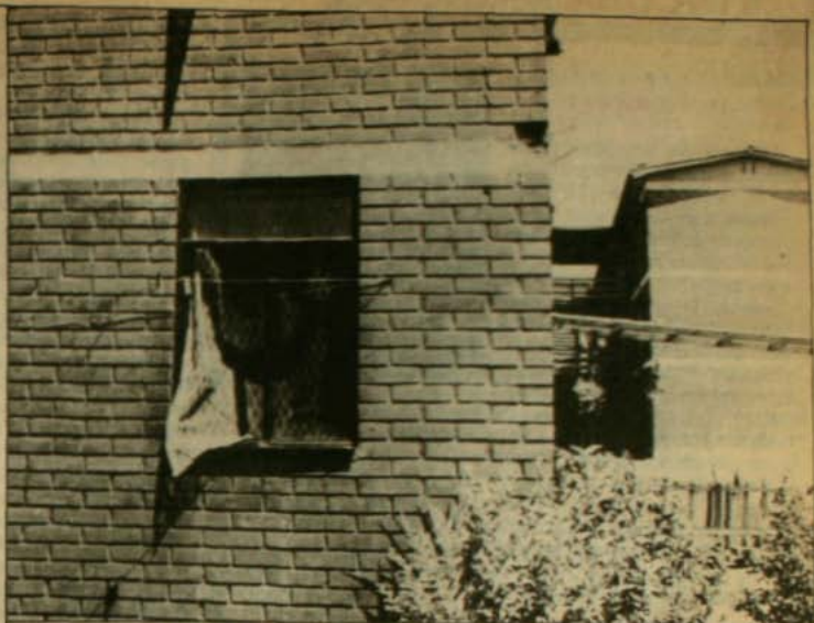
Las grietas en las viviendas son muchos acusadores.
