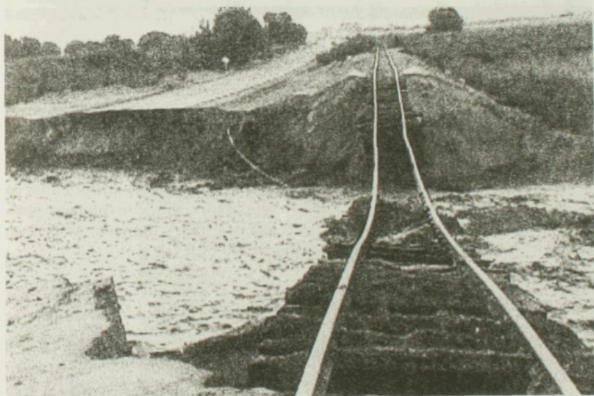
Puente Zascapa (km 16) destruido.
